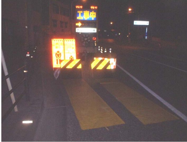
大型電光表示板とデルタクッション
