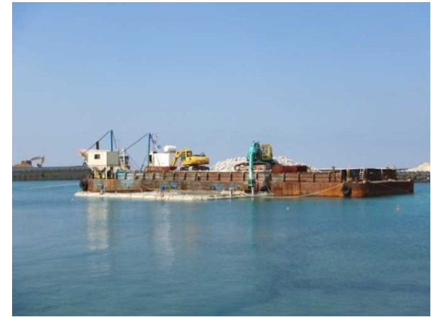
③ 【V工区】通水路部基礎捨石投入状況 (平成29年5月撮影)
