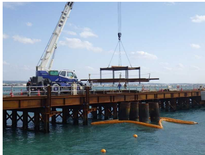
① 【南側進入灯】平成29年12月撮影
