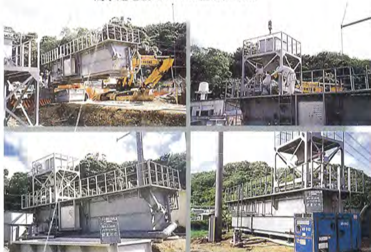
濁水処理機NAW100型設置状況
