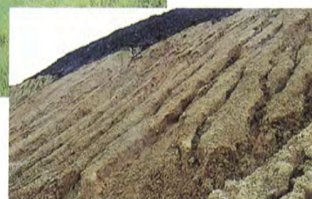
同じ切土法面でも赤土対策をしている所と、していない所の差ははっきりとできました。何もしていない所は大雨のたびにエロージョン(ガリ)が見られました。
