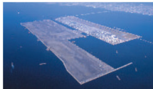
第二滑走路の暫定供用に向け工事が進む関西国際空港 写真提供: 関西国際空港用地造成株式会社
