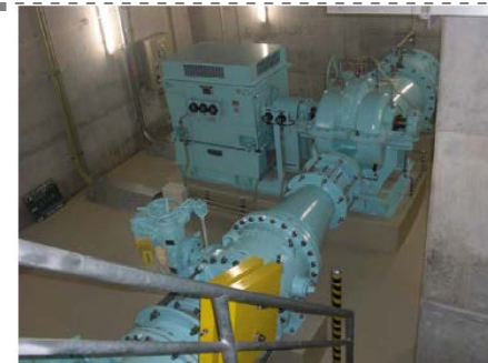
水力発電設備
