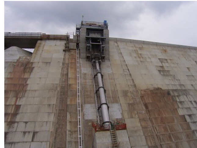
【選択取水設備全景】
