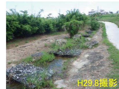
匍匐魚道における回遊性種の確認状況
