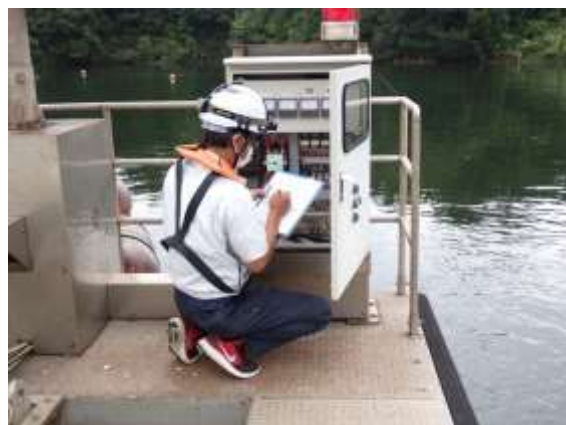
機械設備の巡視
