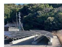
太陽光発電施設
