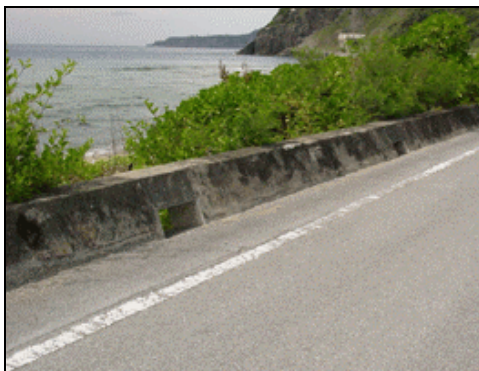
写真 5.3.2 防波堤の切り込み
