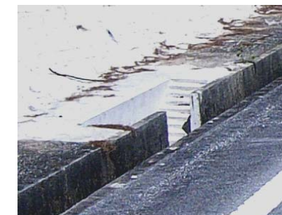
【スロープ付き側溝】
