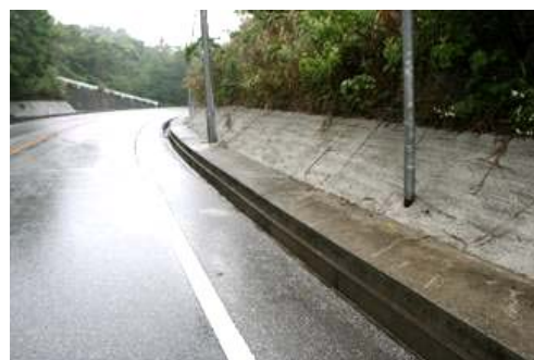
写真 張りコン対策実施状況
