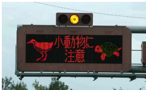
写真 道路情報表示盤（県道 2 号線）
