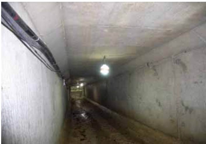
暗渠照明設置状況 (40W昼光色蛍光灯)
