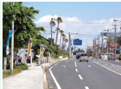
② 前兼久地区電線共同溝
