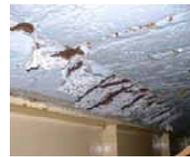
床版下面の損傷状況
