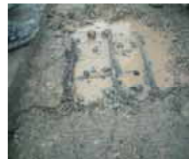
床版上面の損傷状況
