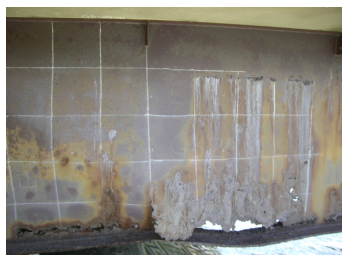
図-2 桁端部による崩落前の腐食状況
