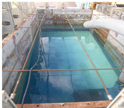
〔写真-7〕凝集剤使用後の上水と沈降した浮泥
