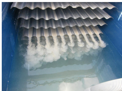
〔写真-11〕傾斜板と堆積した浮泥
