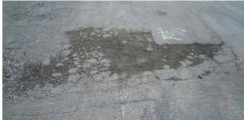
(b) 床版上面の土砂化
