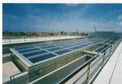
◀ 太陽光発電設備
