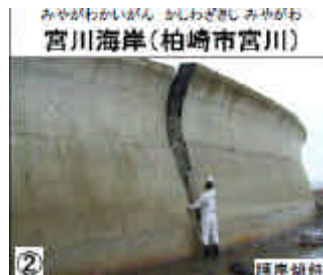
② 海岸施設被害
