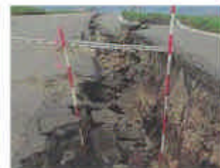
H16年中越地震による堤防被災
