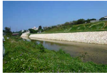
水際や河床が単調となっ てしまった多自然川づくりの事例
