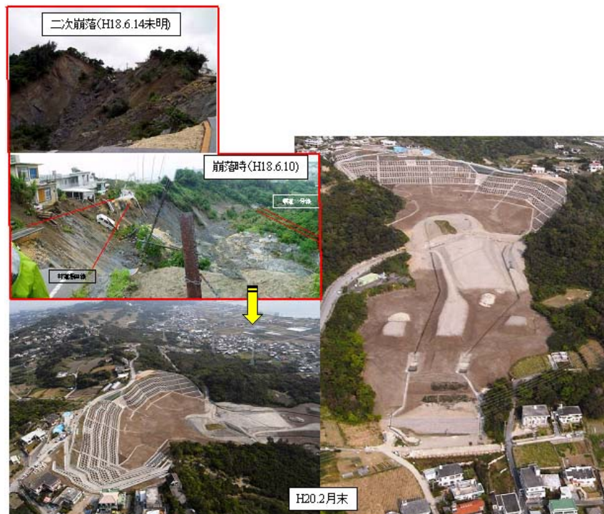
地すべり対策事業（安里地区（特定緊急）地すべり対策事業）
