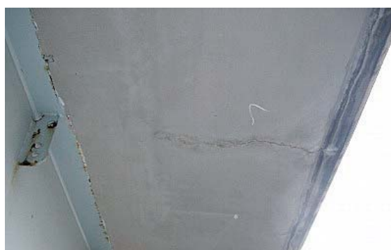
写真-5 吊り金具の腐食
