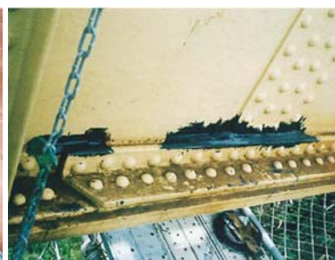
写真- 7.3 損傷部のパテ塗付状況
