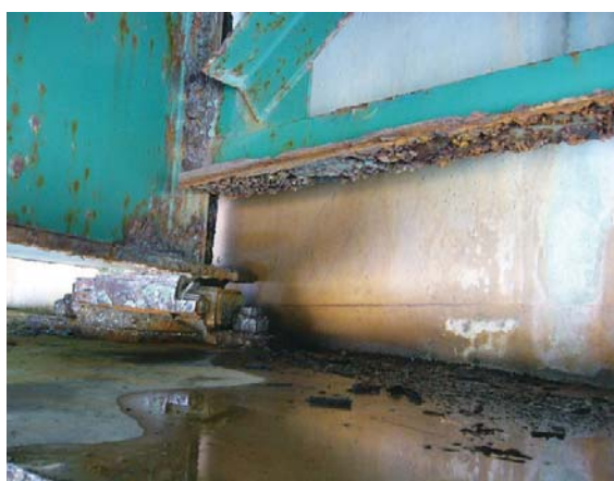
写真-1.4 桁端部の腐食
