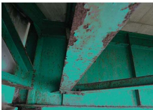
写真-1.3 部材エッジ部の腐食
