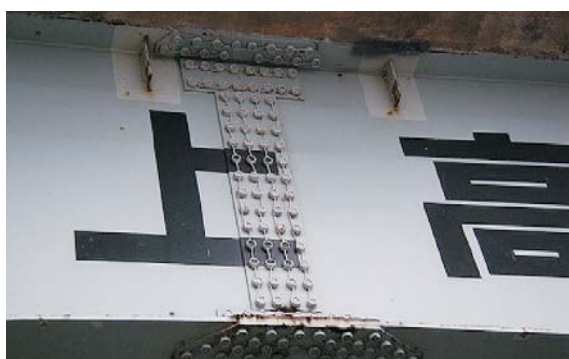
写真-4 吊り金具の腐食
