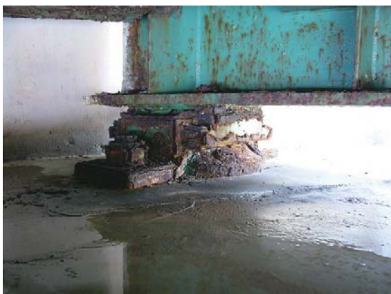
写真－１ 支承の腐食（支承カバーなし） 施工後約 20 年
