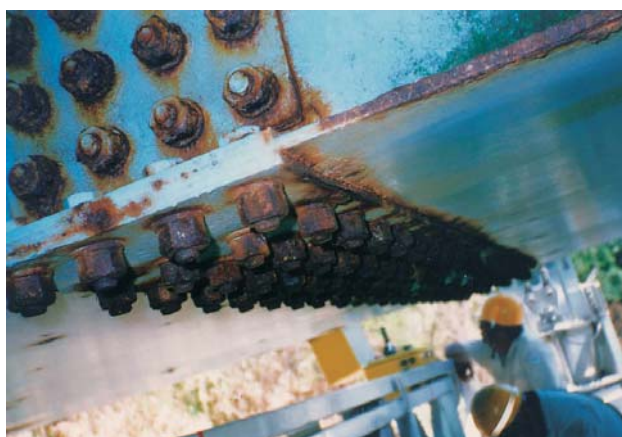
写真－ 1.2 現場継手部の腐食
