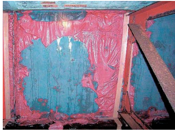
④塗付後 18 時間 (塗膜が軟化して自重で一部はく離している)
