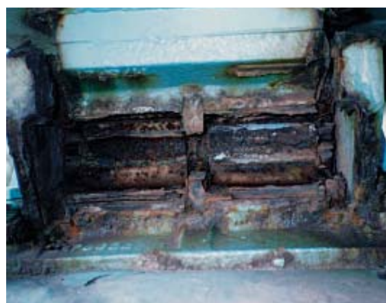
写真-1.5 支承部の腐食
