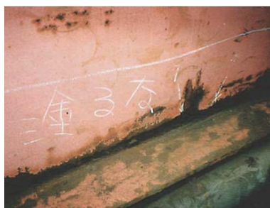
写真- 7.1 主桁溶接部の腐食
