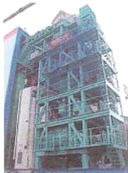
流動化処理土 製造プラント全景
