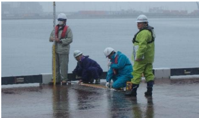
那覇港湾・空港整備事務所による被災状況調査
