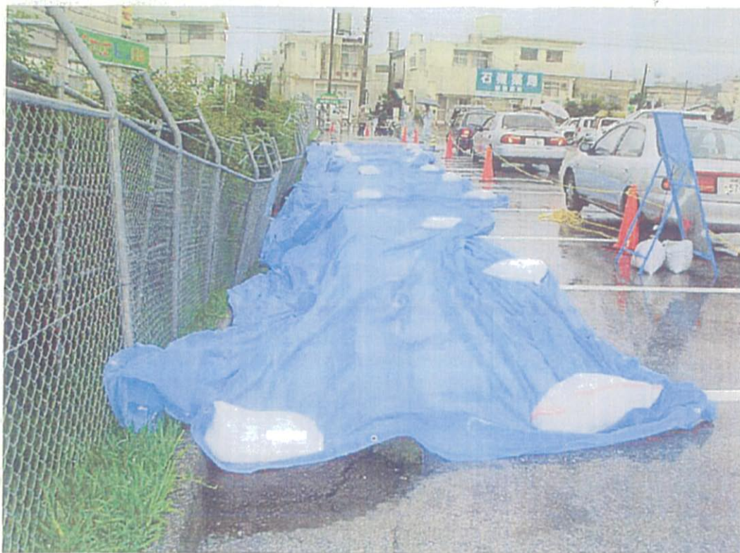
安謝川那覇市石嶺サンエー前割石積み崩壊箇所
