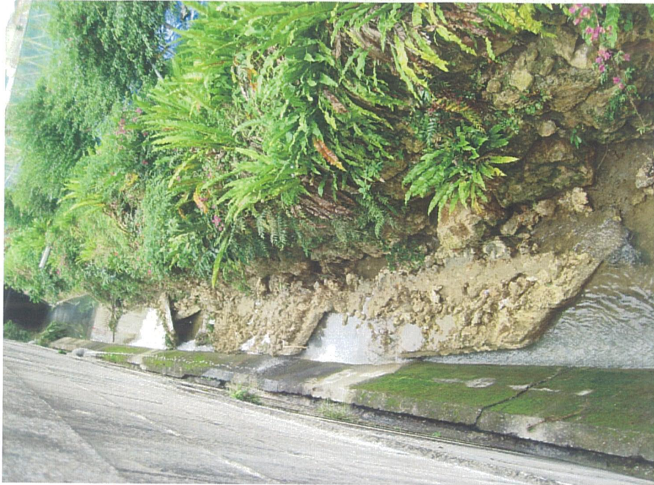
河道内に崩れた護岸ブロック(6月15日撮影)
