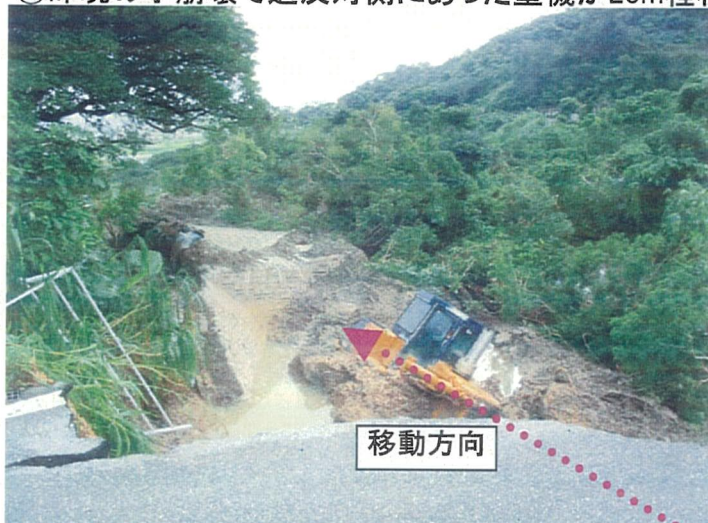
②昨晚の小崩壊で道反対側にあった重機が20m程移動
