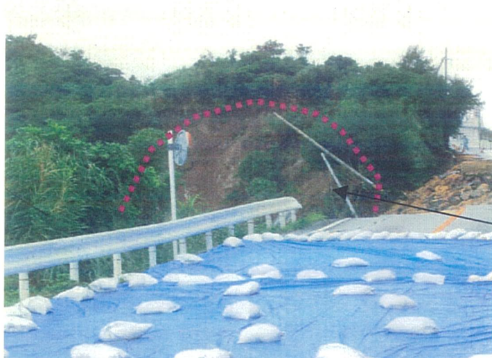
③小崩壊斜面の状況【拡大】
