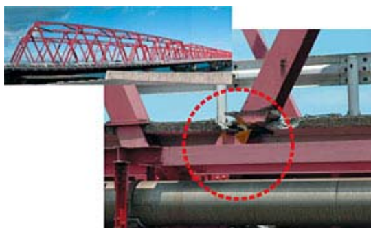
国道23号木曽川大橋(昭和63年) (中部地方整備局HP) 落橋の可能性もあった橋
