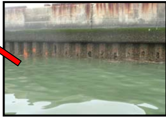
不荷役化する岸壁の老朽化状況
