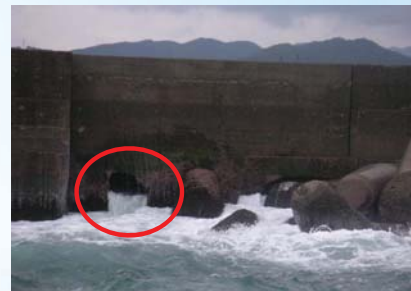
消波ブロックの沈下
