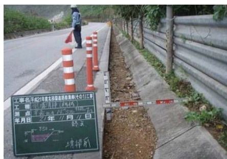
【側溝の土砂堆積 状況（清掃前）】
