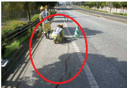
【ひび割れ状況】
