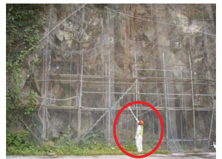
【法面の異常発見】
