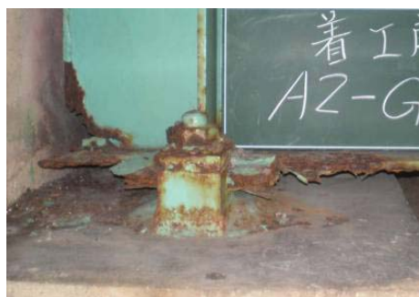
【補修前（支承の損傷）】
