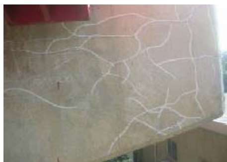
【補修前（ひびわれ）】
