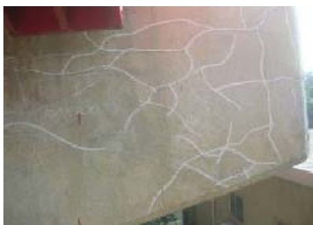
【補修前（ひびわれ）】
