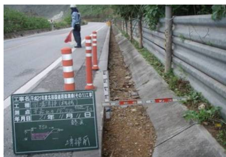
【側溝の土砂堆積 状況（清掃前）】
