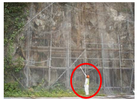
【法面の異常発見】
