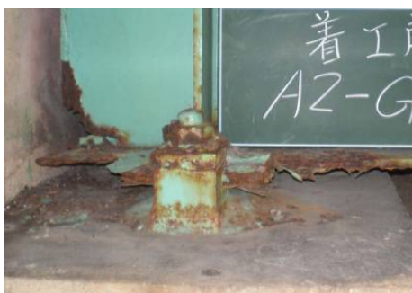
【補修前（支承の損傷）】
