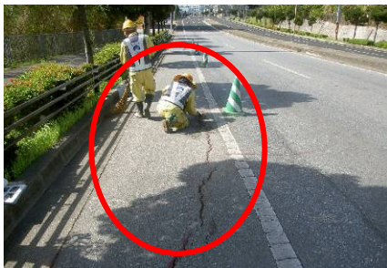
【ひび割れ状況】
