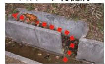
スロープ付側溝
