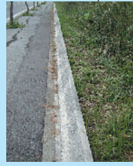
エコパネル設置 小動物を交通事故から守るため、道路侵入防止のためのパネルが設置されています
