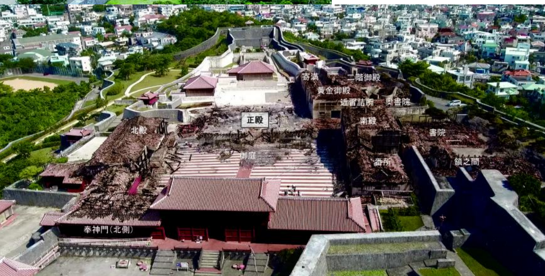
火災後（令和元年11月1日）
