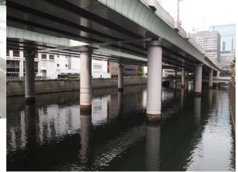
→水辺に近づけず、まちと切り離された空間となっている。
