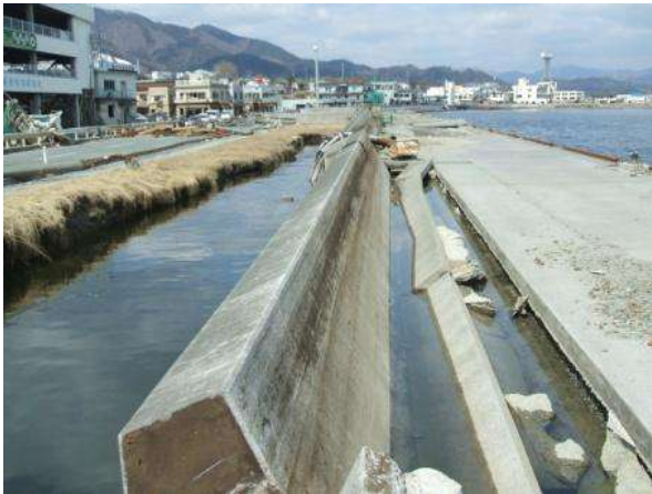
堤体が陸側に倒壊
