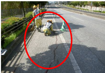
【ひび割れ状況】
