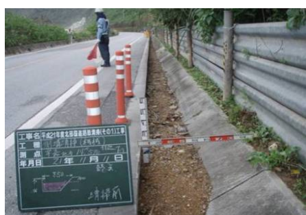
【側溝の土砂堆積 状況（清掃前）】
