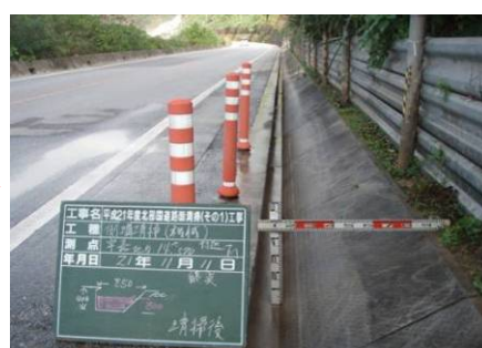
【側溝の土砂堆積 状況（清掃後）】
