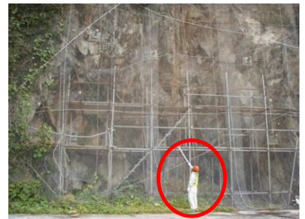
【法面の異常発見】
