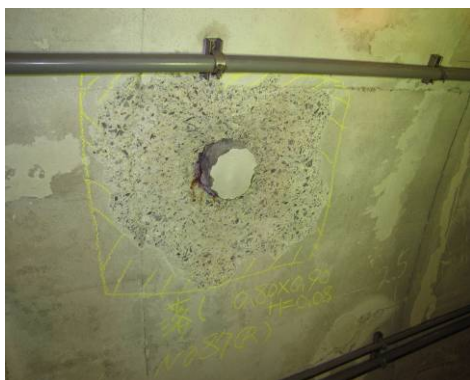
【補修前（コンクリートうき・ 叩き落とし）】
