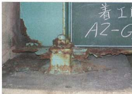
【補修前（支承の損傷）】
