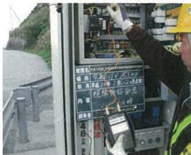
【電気設備点検 (道路施設監視カメラ)】
