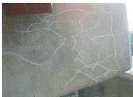
【補修前（ひびわれ）】
