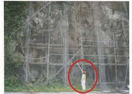
【法面の異常発見】
