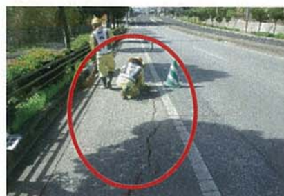
【ひび割れ状況】
