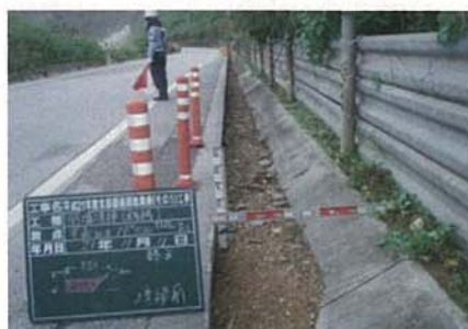
【側溝の土砂堆積 状況（清掃前）】
