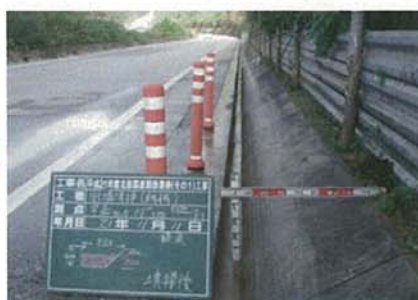
【側溝の土砂堆積 状況（清掃後）】
