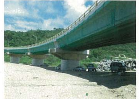
【コンクリート落下事故防止】
