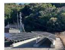
太陽光発電施設
