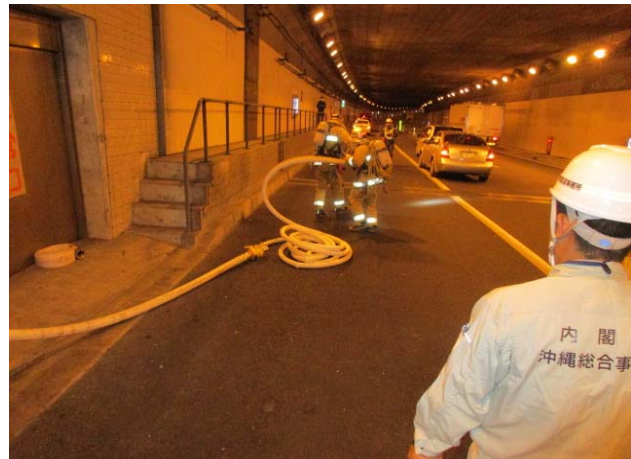
消火栓動作確認
