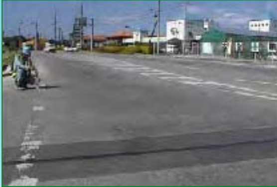
施工前（路面と橋との段差があった）
