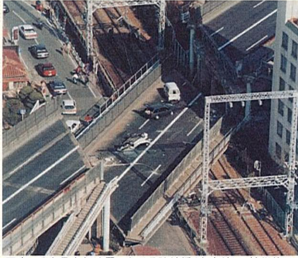
写真. 兵庫県南部地震における跨線橋（在来線）の被災状況
