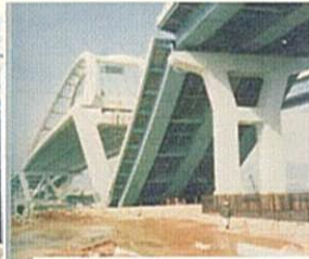
写真. 阪神高速道路の落橋 (西宮市甲子園浜)
