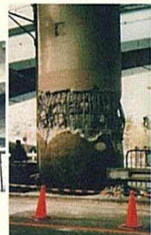
写真. 阪神高速道路の 橋脚の被災 (神戸市長田区西尻池町)
