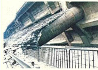
写真. 阪神高速道路の 橋脚の被災 (神戸市東灘区深江本町)
